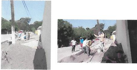
foto 1 torta de concreto
